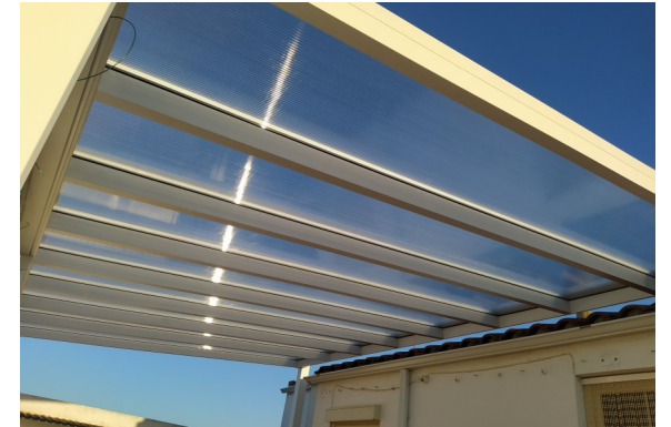
Pérgola Winter Garden inclinada, 4 columnas, cobertura con vidrio laminado. Vista inferior.
